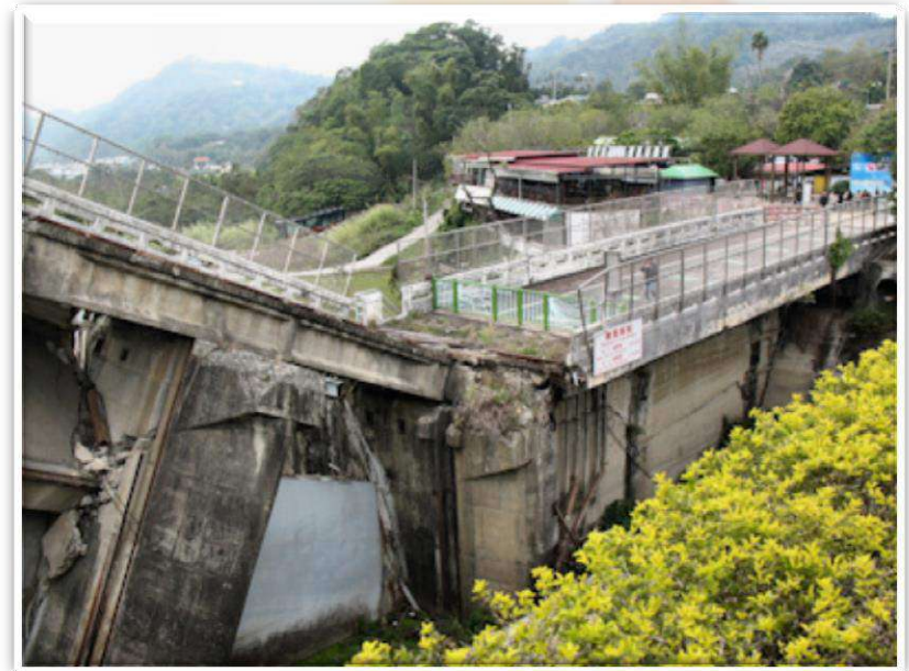
921地震造成台中石岡水壩嚴重破壞
